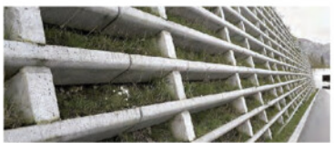
Referenz begrünte Lärmschutzwand
