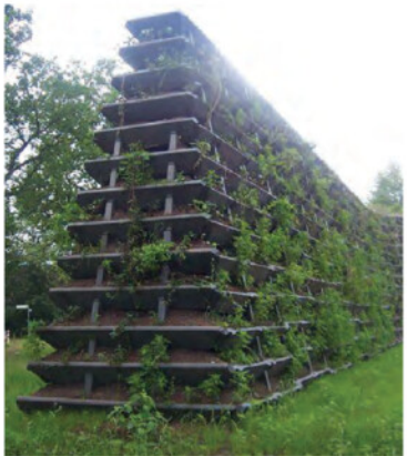
Referenz begrünte Lärmschutzwand
